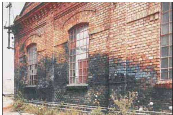
Ehemalige Chemiefabrik: kontaminiertes Mauerwerk; Quelle: Archiv der PORR Umweltechnik GmbH
